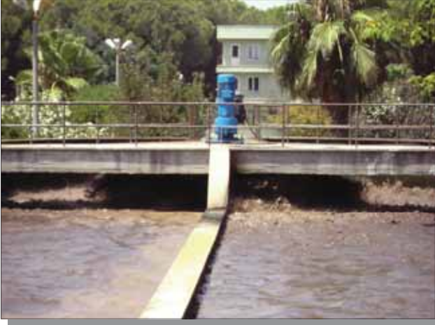
Belek I AAT, 2x45 kW (frekans invertörlü)
